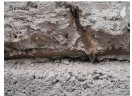
Una mala impermeabilización puede traer consigo agrietamientos del concreto y óxido sobre el acero.
